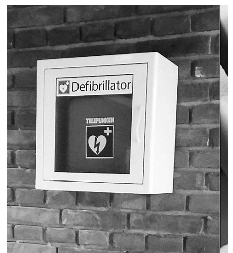
Der neue Defibrillator befindet sich im Vorraum der Turn- und Versammlungshalle, Schumannstraße 8.
